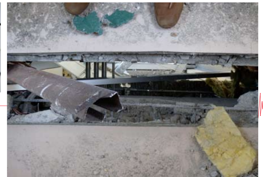
本棟とエレベーター棟の継ぎ目には、4階から8階まで大きな亀裂が入った。
